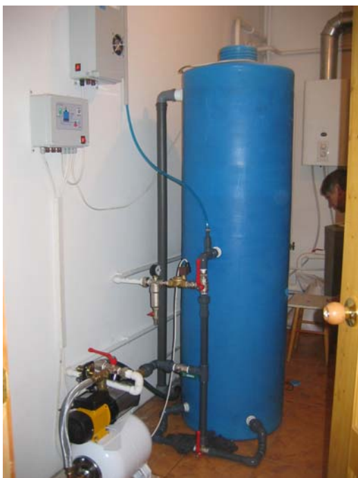
Рис.1. Установка озono-сорбционной очистки воды производительностью 2 м 3 /час
