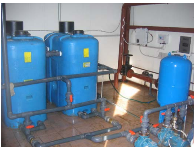
Рис.2. Установка озono-сорбционной очистки воды производительностью 15 м 3 /час
